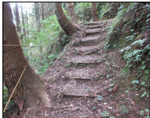
16号墓と17号墓間の階段：7段補修予定
